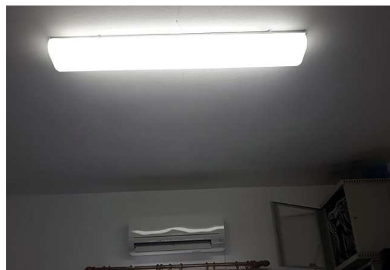
Εικόνα 8β: Φωτιστικά LED τύπου φθορίου σε γραφείο.
